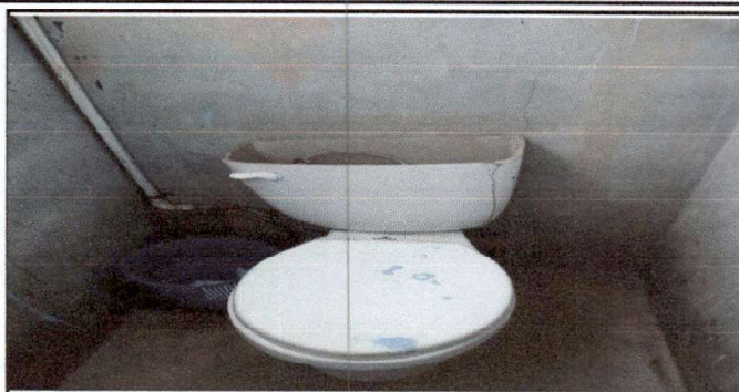
Foto 2: Modulo 2, Servicios Sanitarios y sus accesorios
