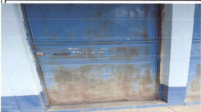
Foto modulo 2. puertas de metal
